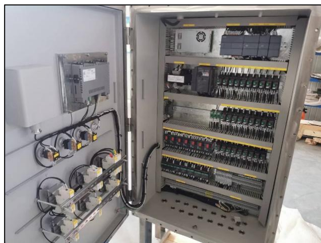
防爆电柜内部
